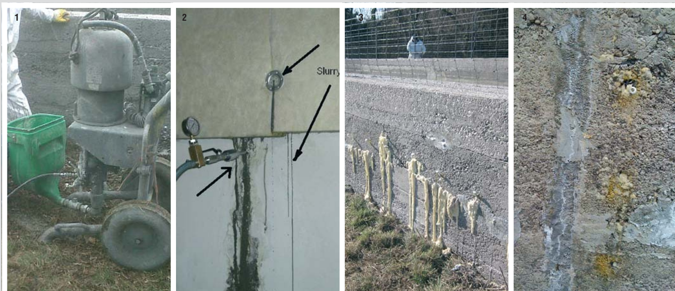
Foto 1) Miscelazione del Penetron Inject, bicomponente, in apposita pompa da boiacca cementizia fluida - Foto 2) Predisposizione dei packer da iniezione e iniezione della boiacca viscosa a pressione - Foto 3) Penetron Inject può essere utilizzato insieme a resine poliuretatiche idroespansive elastiche - Foto 4) Reazione cristallina sigillante in una fessurazione
