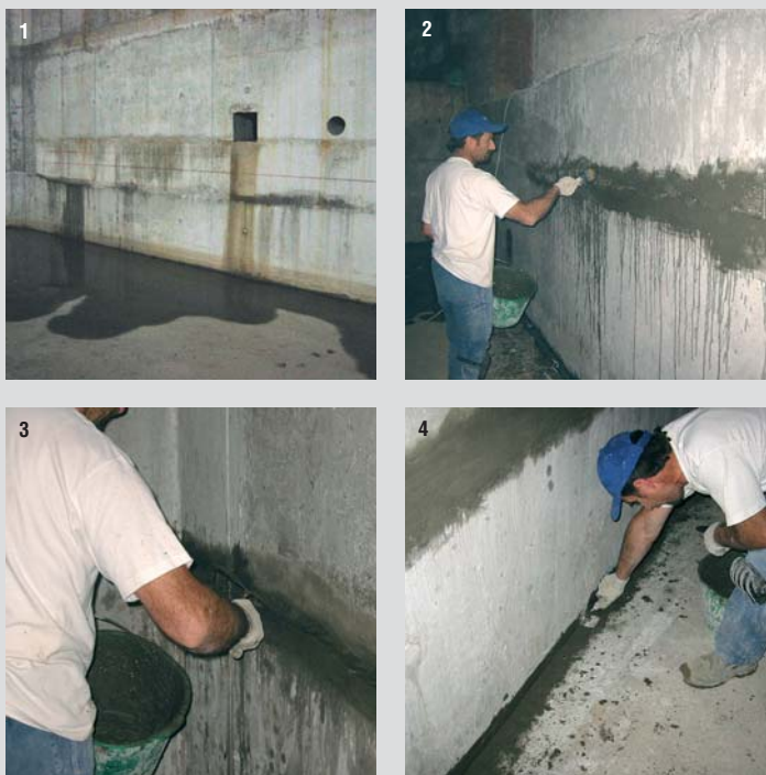
Foto 1) Visione generale di tipiche infiltrazioni in strutture in calcestruzzo interrato Foto 2) Apertura con scasso delle “non conformità” e trattamento di fondo con Penetron Standard Foto 3) Stuccatura con Penecrete malta Foto 4) Trattamento finale delle riparazioni con Penetron Standard
