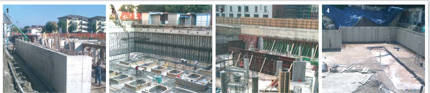
Foto 1) Strutture interrate doppio cassero a pannelloni tradizionale (Residenziale Cascina Casella, Cremona) - Foto 2) Strutture interrate contro pali (Residenziale Via Monte Ortigara, Torino) - Foto 3) Strutture interrate contro diaframmi (Residenziale Via Viganò, Milano) - Foto 4) Cassero a perdere doppia lastra BILBOTPROOF® (Residenziale Strada Valsalice, Torino)
